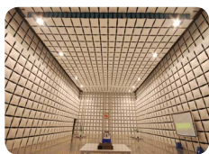
Лаборатория с камерой для электромагнитных испытаний
